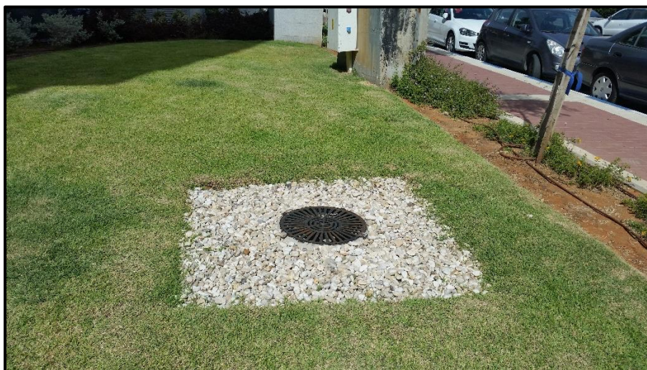
איור 8 - שוחת שטח מוקפת חצץ
